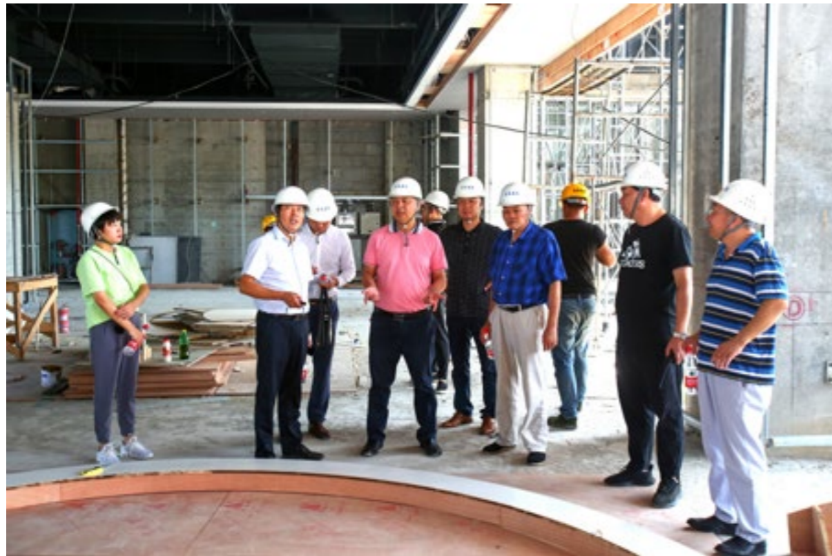
▲ 于泳波总裁一行考察武汉东合中心三期南区办公楼公共区域精装修项目
